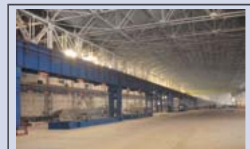
Отопление цеха системой ГИИ
