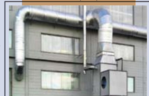
Теплогенератор наружной установки
