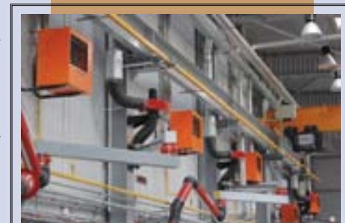
Отопление помещения подвесными теплогенераторами
